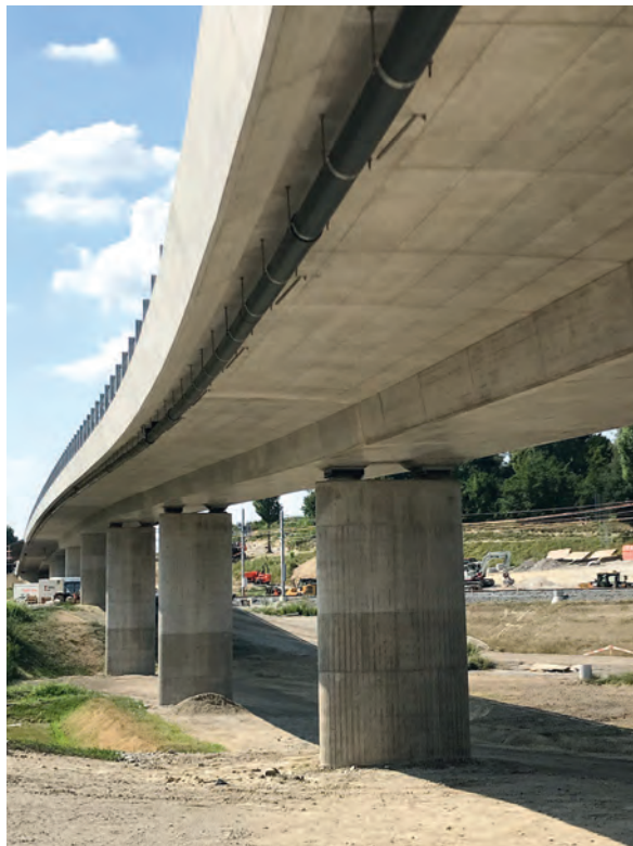
Fig. 8 Vue de l'intrados du pont et des piliers. View of superstructure and piers from below.
