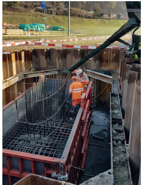
Fig. 9 Bétonnage de la semelle sur pieux du pilier 3. Concreting of pile cap of pier 3.
